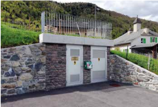
Daviaz places de parcs et station transformatrice
